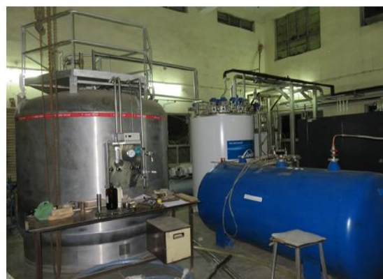
Linde 140 Helium liquefier
